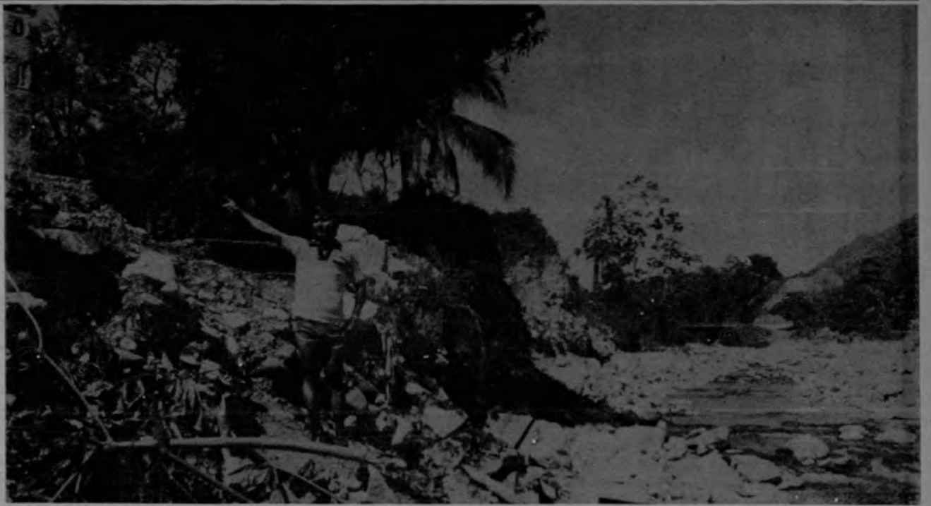
El dirigente Alcides Mora muestra los daños que las aguas causaron al dique que protege a Ciudad Neilly. Los vecinos demandan que la obra sea reparada antes del inicio del próximo invierno.
